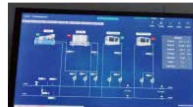
智慧高效中央空调系统
